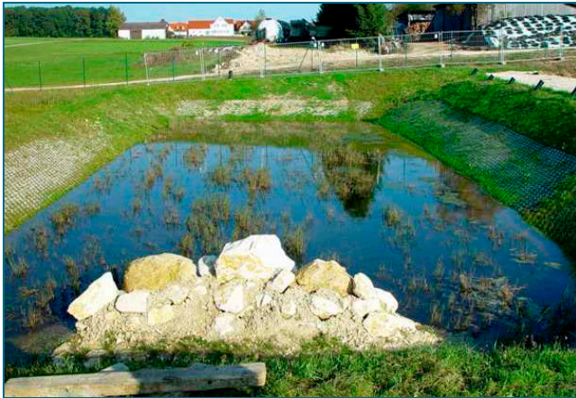
Abb. 9: Rückhaltung und Reinigung des Wassers in einer Bodenfilteranlage
